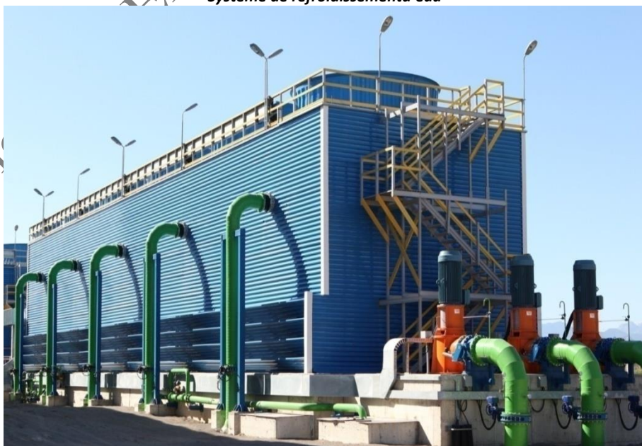
Système de refroidissement d'eau
