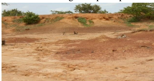
Photo 7: Dégradation des berges
