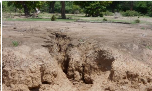
Photo 4: Erosion de berge et ravinement
