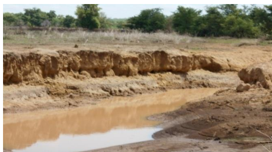
Photo 3: Erosion de berge avec éboulement
