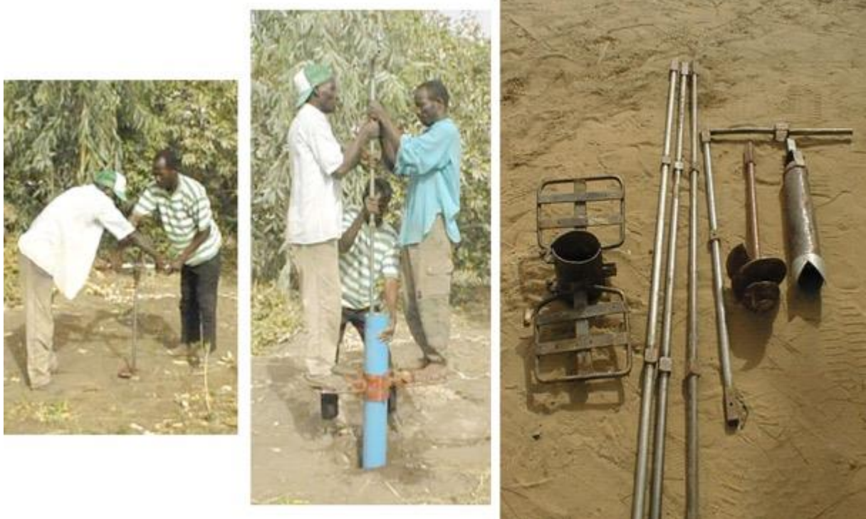
Image 1 : Foration à l'aide de la tarière manuelle et matériels de forage (Images PIP 2, 2002)
