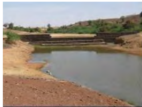
Photo 102: Dépôt sédimentaire en amont du seuil – barrage du kori Soudouré 2009
