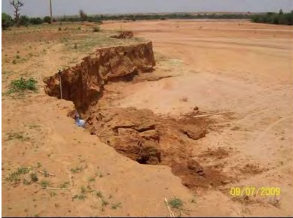
Photo 92: Effondrement et recul de berge de la rive concave (sur le profil en travers N°4) du kori Boubon en septembre 2009
