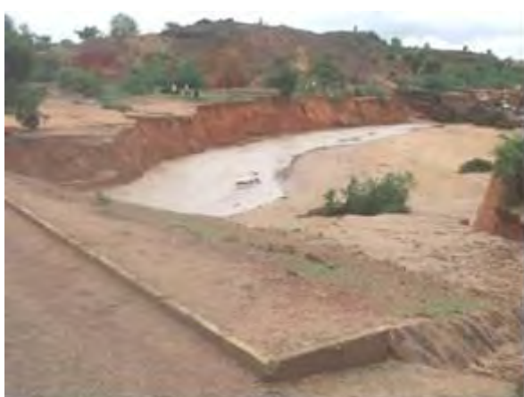
Photo 105: Section du kori Soudouré en amont du pont emporté à la suite des reculs de berges engendrés par la crue du 5 août 2007
