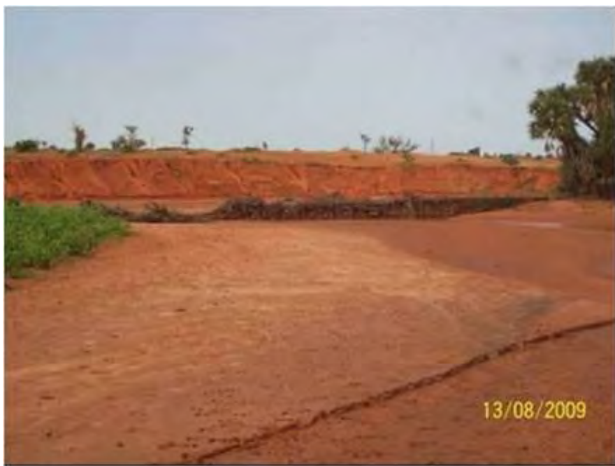
Photo 118: Seuil d'épandage endommagé par les crues sur le kori Boubon
