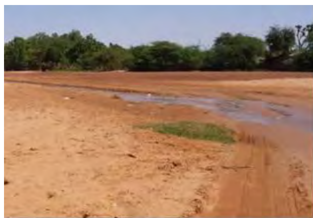
Photo 47: Piste et parking en latérite réalisé en novembre 2009 sur le cône du kori Kirey
