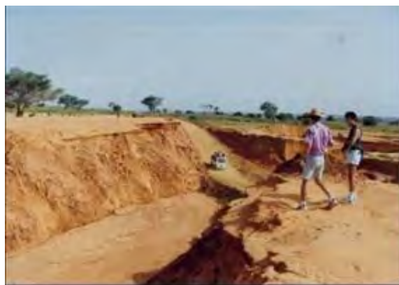
Photo 63: Verrous des mares emportés par la crue amont du bassin du kori Léli Mamane Nialé
