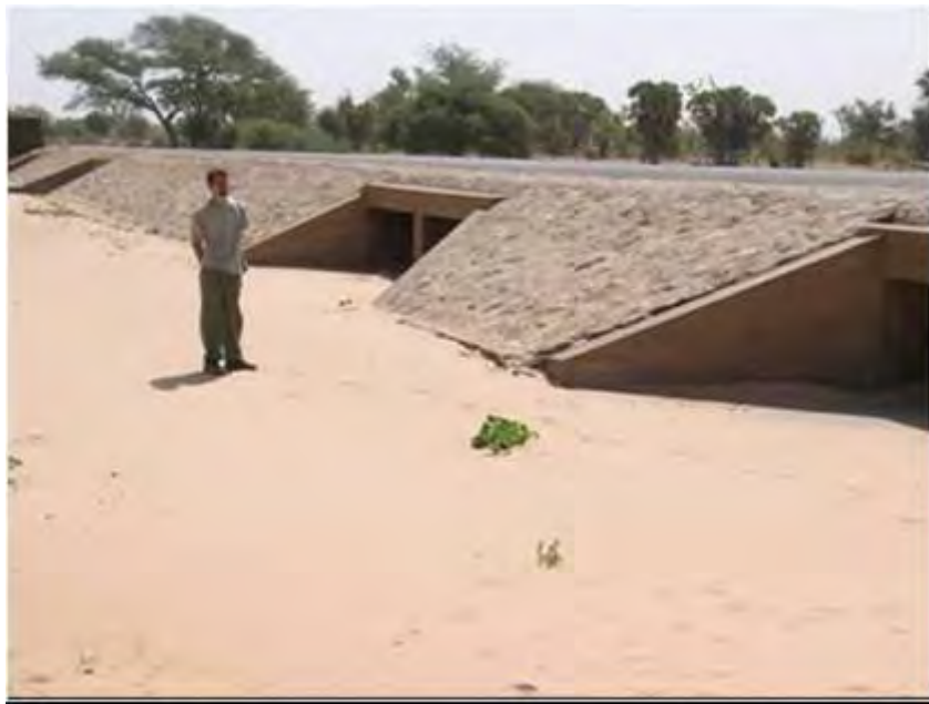
Photo 103: Ensablement des buses du pont sur le kori Karma (bras secondaire) Gourou en rive droite de fleuve en février 2007
