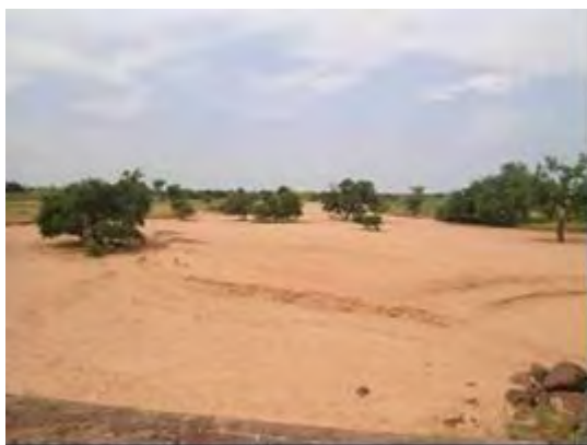
Photo 64: Rupture de buses du goudron et creusement d'une nouvelle vallée sur la route Niamey – Say dans la partie aval du kori Léli Mamane Nialé en 1998 (Photos Rajot J-L).
