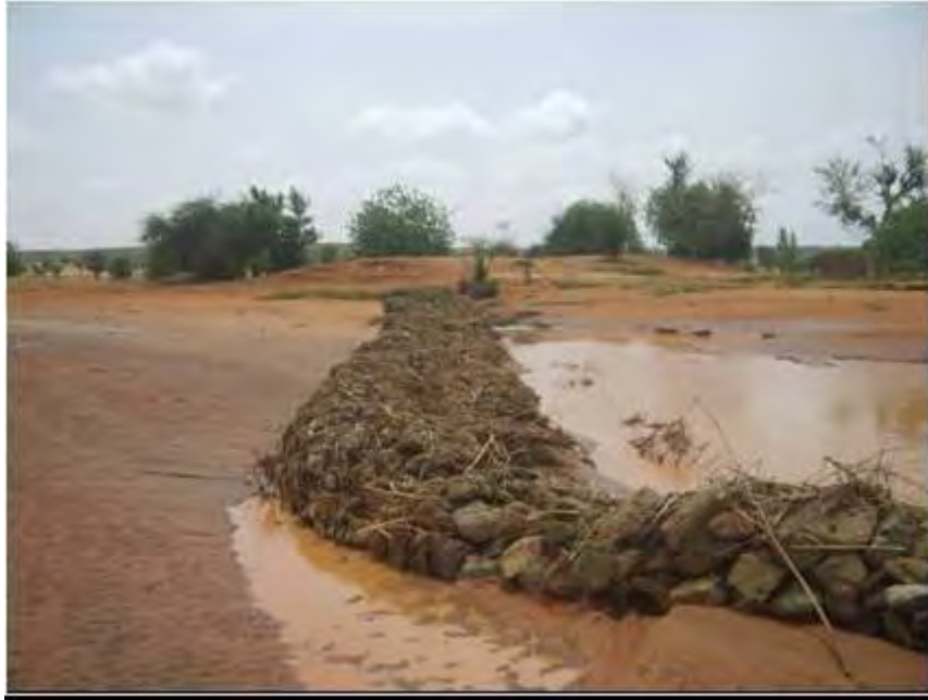
Photo 119: Seuil d'épandage sur le kori Boubon endommagé juste après sa construction en 2009
