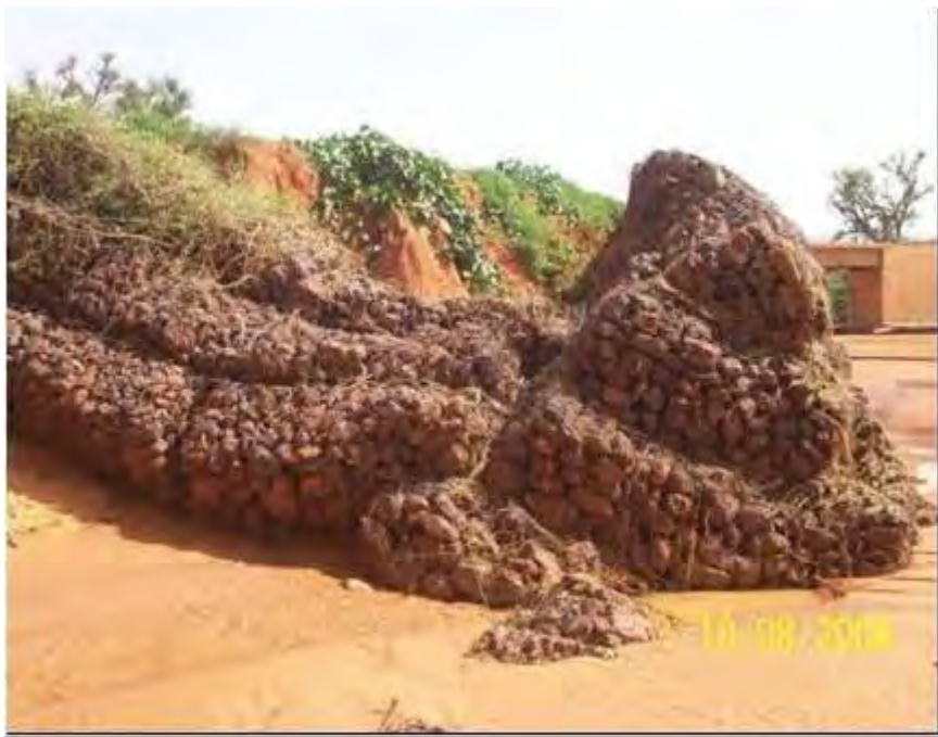
Photo 120: Epis en gabions de protection des berges endommagés dans le lit du kori
