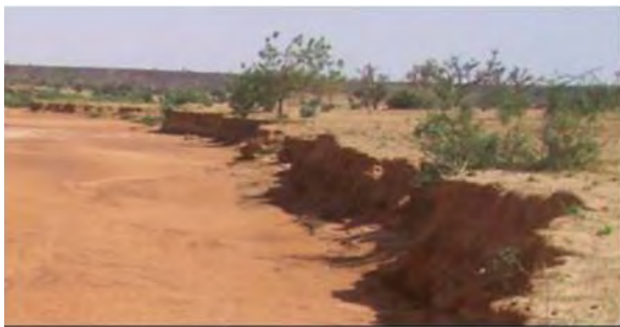
Photo 128: Berges sans protection sur la rive gauche du kori Boubon en 2008
