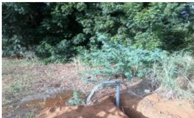
Image 19 : Borne de fin réseau en marche
