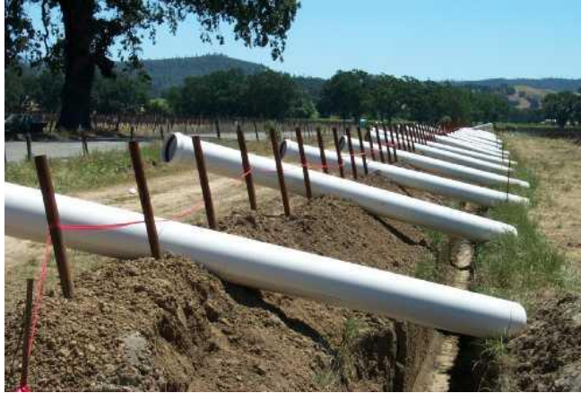
Image 2 : Tuyaux PVC pour conduite principale
