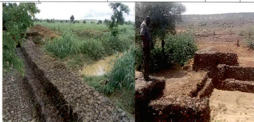
Fonctionnement normal des seuils en gabions de Guidan Magagi et de Tabofat (Août 2017)
