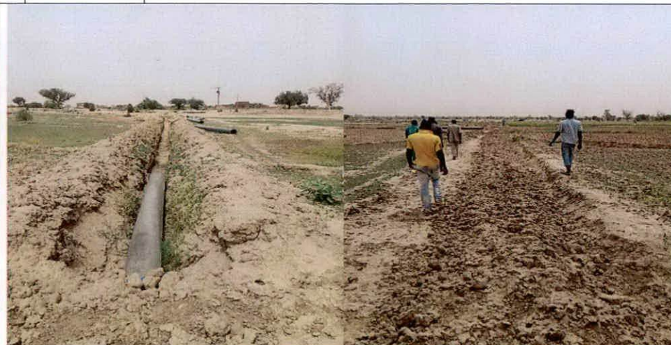
Pose conduites de refoulement des travaux de transfert station de pompage de la ferme de Lossa (Juin 2017)
