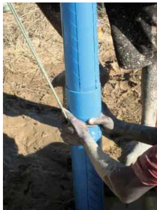
Image 14 : Equipement d'un forage
